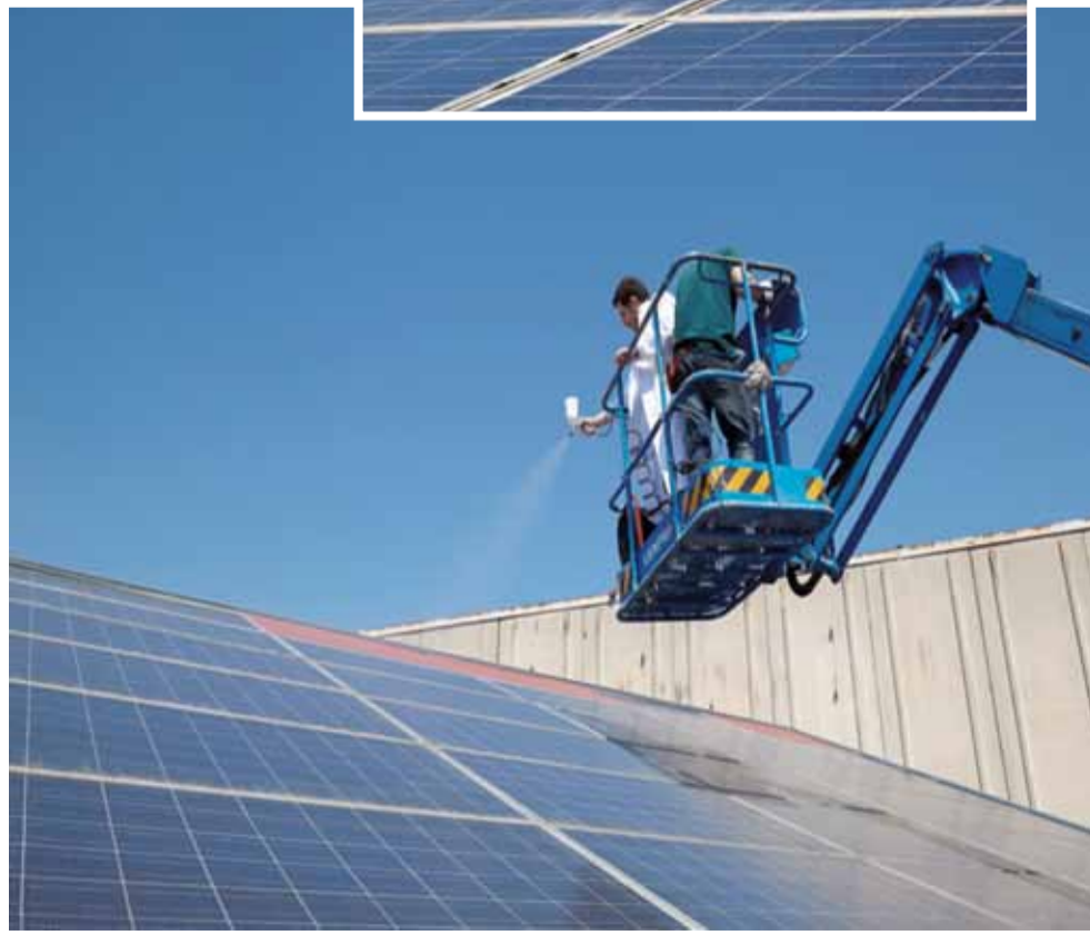
Pannelli fotovoltaici trattati superficialmente con un prodotto fotocatalitico (Nis Materials) in grado di aumentarne la resa del 3,5% e di mantenerli autopulenti
